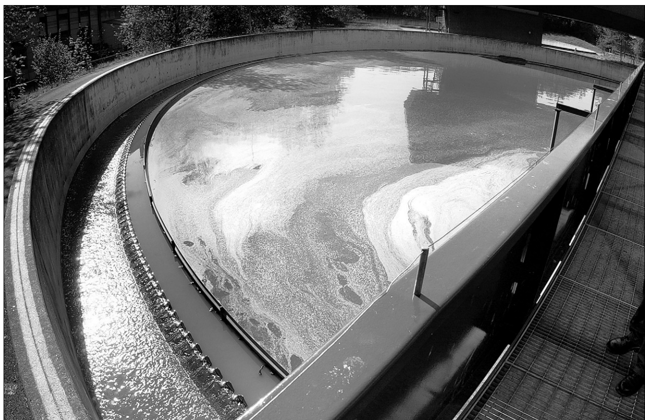
In Zürich bezahlt man höhere Abwassergebühren als anderswo. Im Bild das Klärwerk Werdhölzli.
